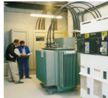
800 kVA - 20 kV / 400 V
