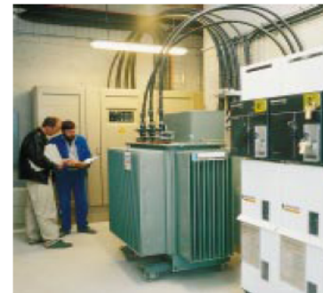
800 kVA - 20 kV / 400 V
